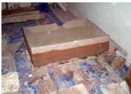
Fig. 35 : Échantillon d'un toit terrasse
