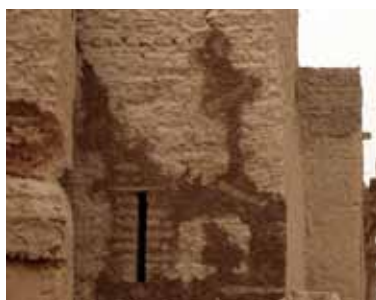
Fig. 57 : Reprise des fissures depuis l'extérieur
