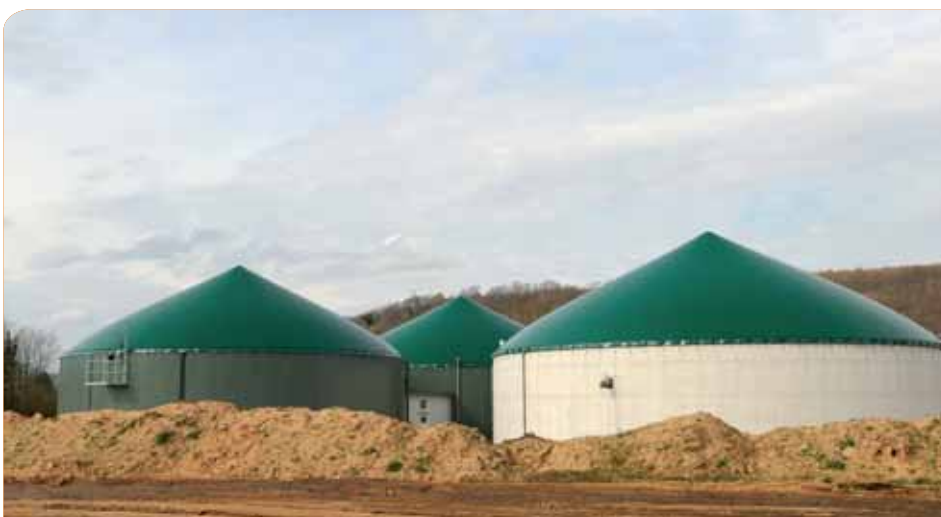
Biomasse : l'Oriental dispose de matières premières pour produire du biogaz
