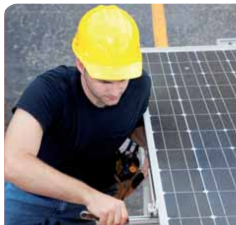
Equipement photovoltaïque : un axe d'amélioration de l'efficacité énergétique
