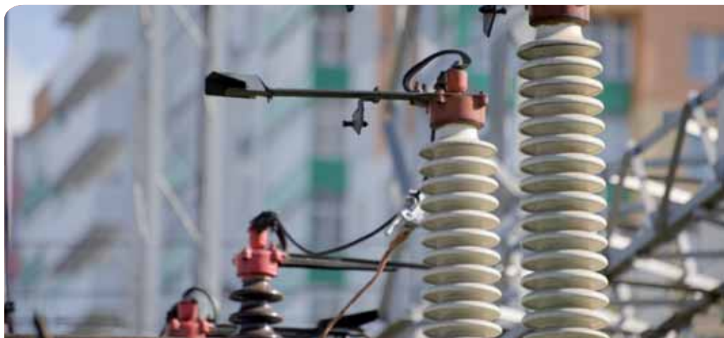
Systèmes centralisés : incontournables pour les puissances élevées
