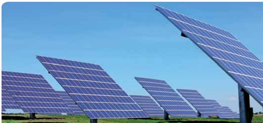
L'exportation vers l'Europe de l'électricité d'origine solaire est envisagée
