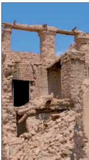
De nombreuses constructions sont menacées de ruine
