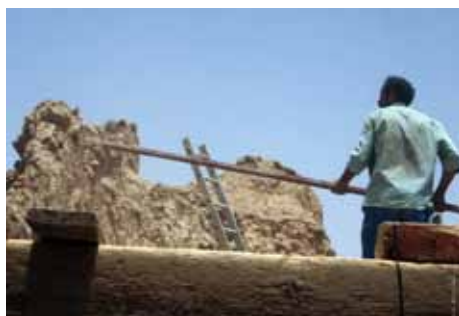
Fig. 47 : Destruction des parties fragiles
