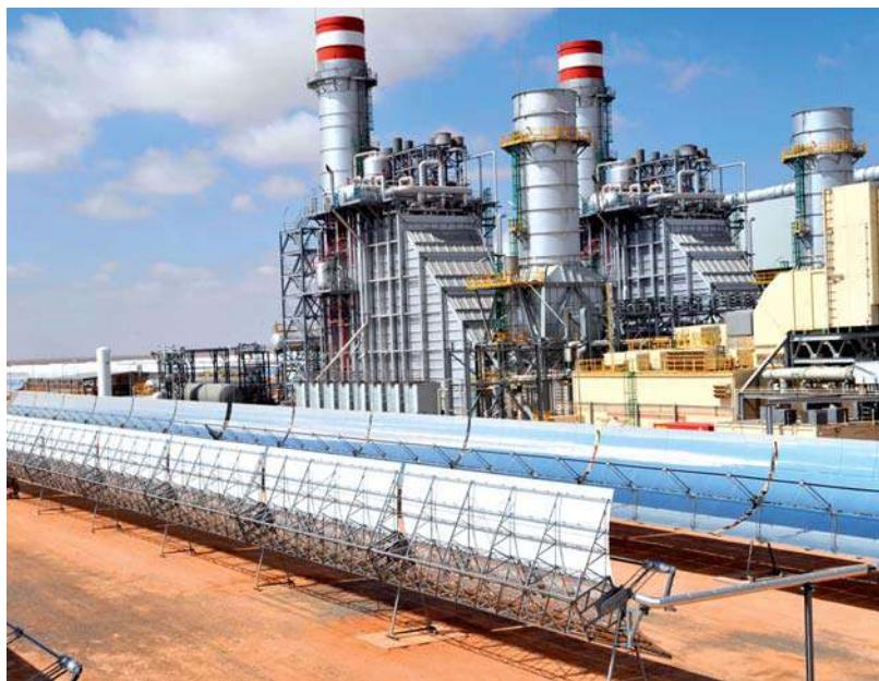
En 2010, l'Oriental a ouvert la première centrale thermo-solaire du pays à Ain-Bni-Mathar
