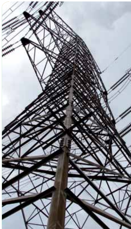
Les autoroutes électriques
