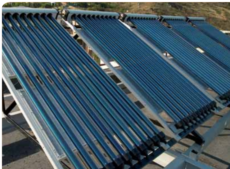
Soleil : le chauffe-eau solaire commence à occuper les terrasses
