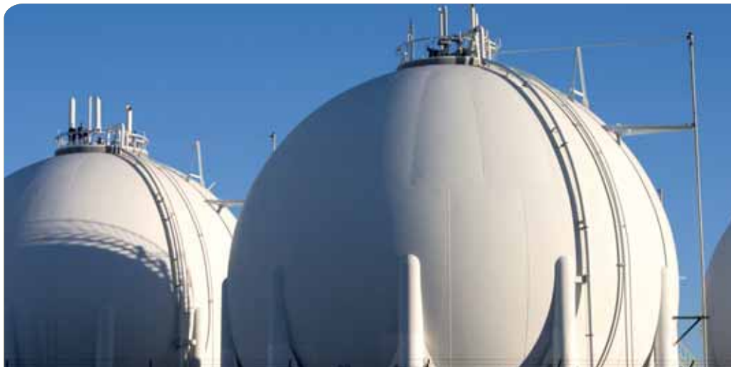
Le gaz : stockage intermédiaire et redistribution sont un enjeu
