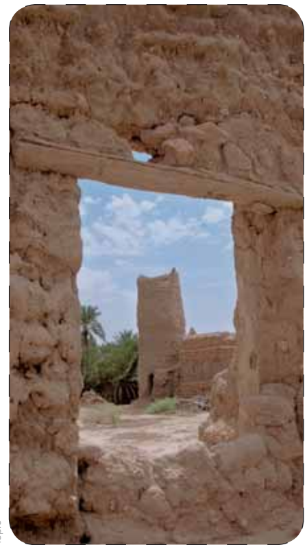
Edifice en voie de dégradation
