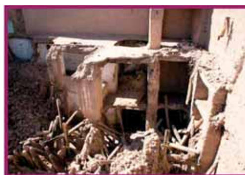
B/2- DEGRADATION DES SYSTEMES HORIZONTAUX (déformations et ruptures des éléments porteurs/pourritures des couvertures horizontales)
