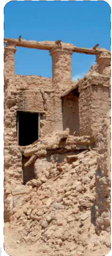
Observation des systèmes constructifs et pathologies
