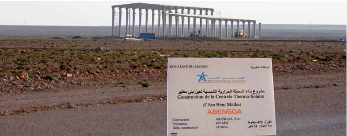
مشروع المحطة الحرارية الشمسية لعين بني مطهر
